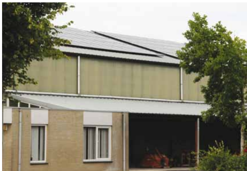
Op het dak liggen sinds twee jaar 250 zonnecollectoren met een jaarproductie van 550 kWh.
